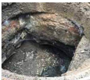
Etat d'une canalisation d'égouttage avant son nettoyage
