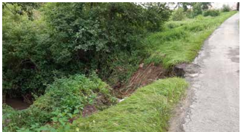
Exemple d'infrastructure publique impactée par les inondations de juillet 2021, ici un égouttage défoncé rue de la Ferme du Bois à Sombreffe
